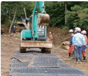
災害復旧現場
